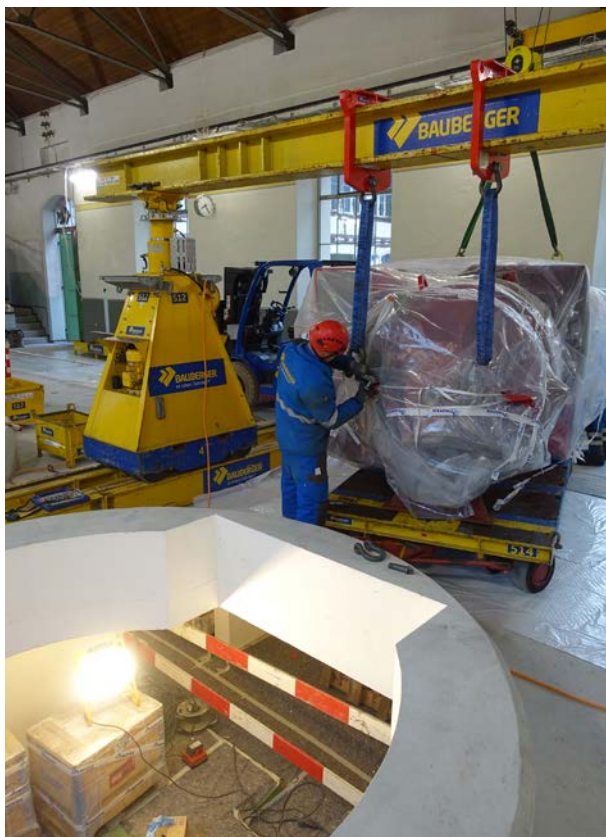
Platzierung der neuen Generatoren im Februar 2022
