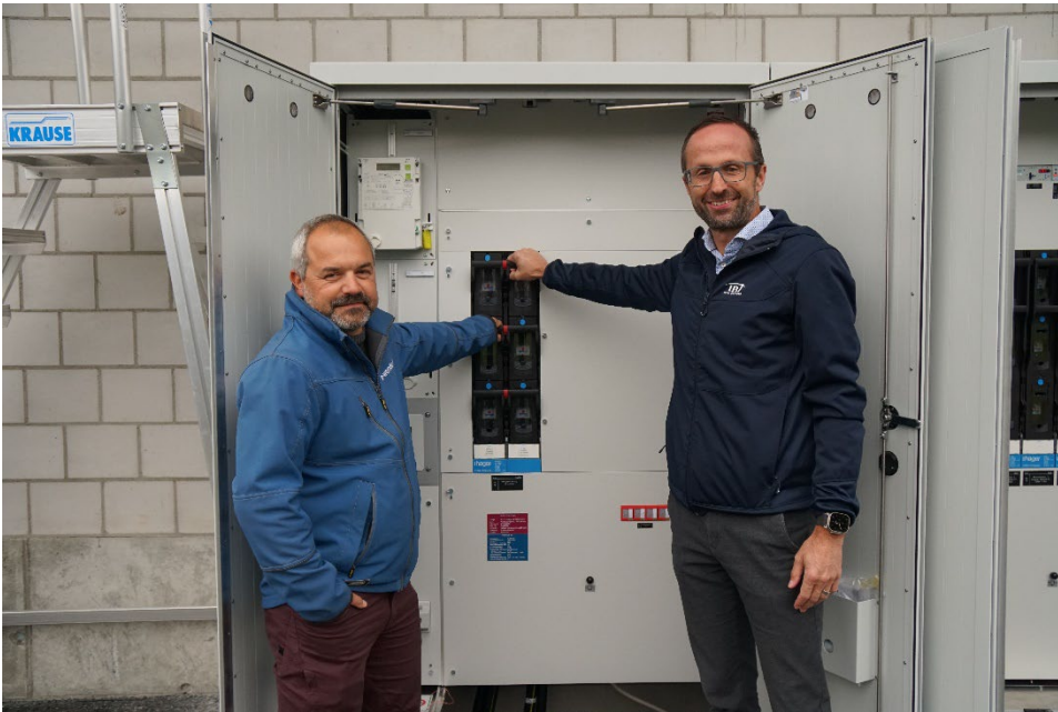
Vlnr: Remo Zumbrunn, Geschäftsleitung Energiewendegenossenschaft, und Helmut Perreten, CEO IBI, nehmen die PV-Grossanlage offiziell in Betrieb.
