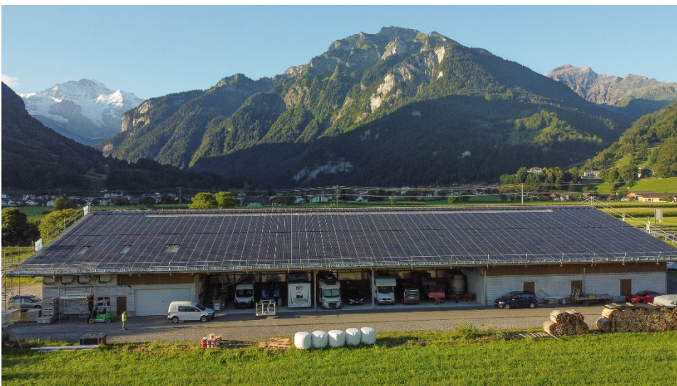
Liefert Strom für rund 120 Haushalte: die PV-Anlage der Solargemeinschaft Pferdesportcenter Matten.
