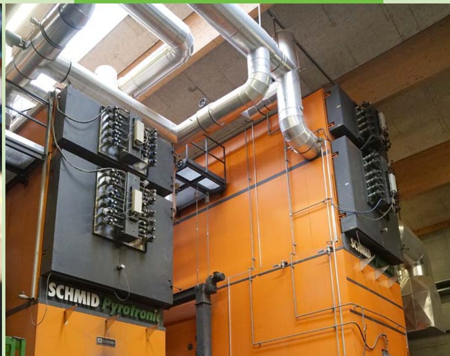
Heizkessel im Fernheizwerk der AVARI AG
