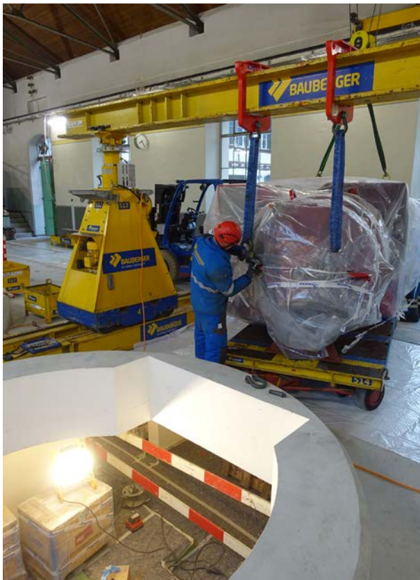
Platzierung der neuen Generatoren im Februar 2022
